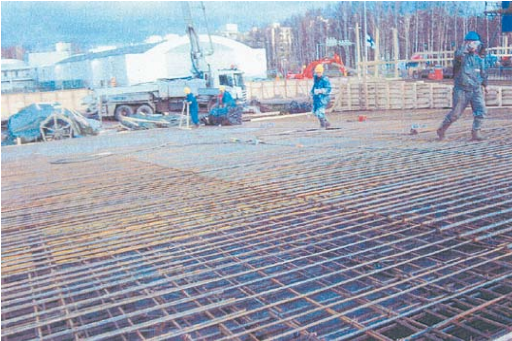
Kuva 1. Vastaavantyyppinen raudoituskenttä, johon NN kompastui.
