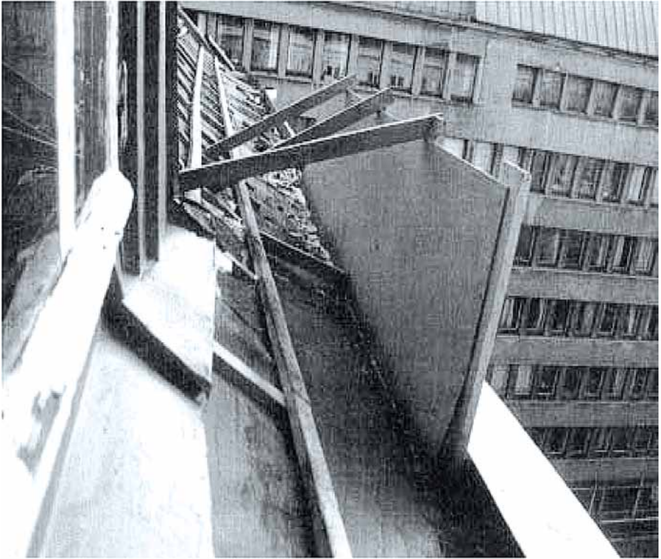
Kuva 5. Vasemmalla kulkuaukkona käytetty ullakkoikkuna. Oikealla tillien pinoamisen käytetty tukilevy. Menehtynyt putosi kaiteettoman katon reunalta, jossa ei ollut edes tukilevyä.
