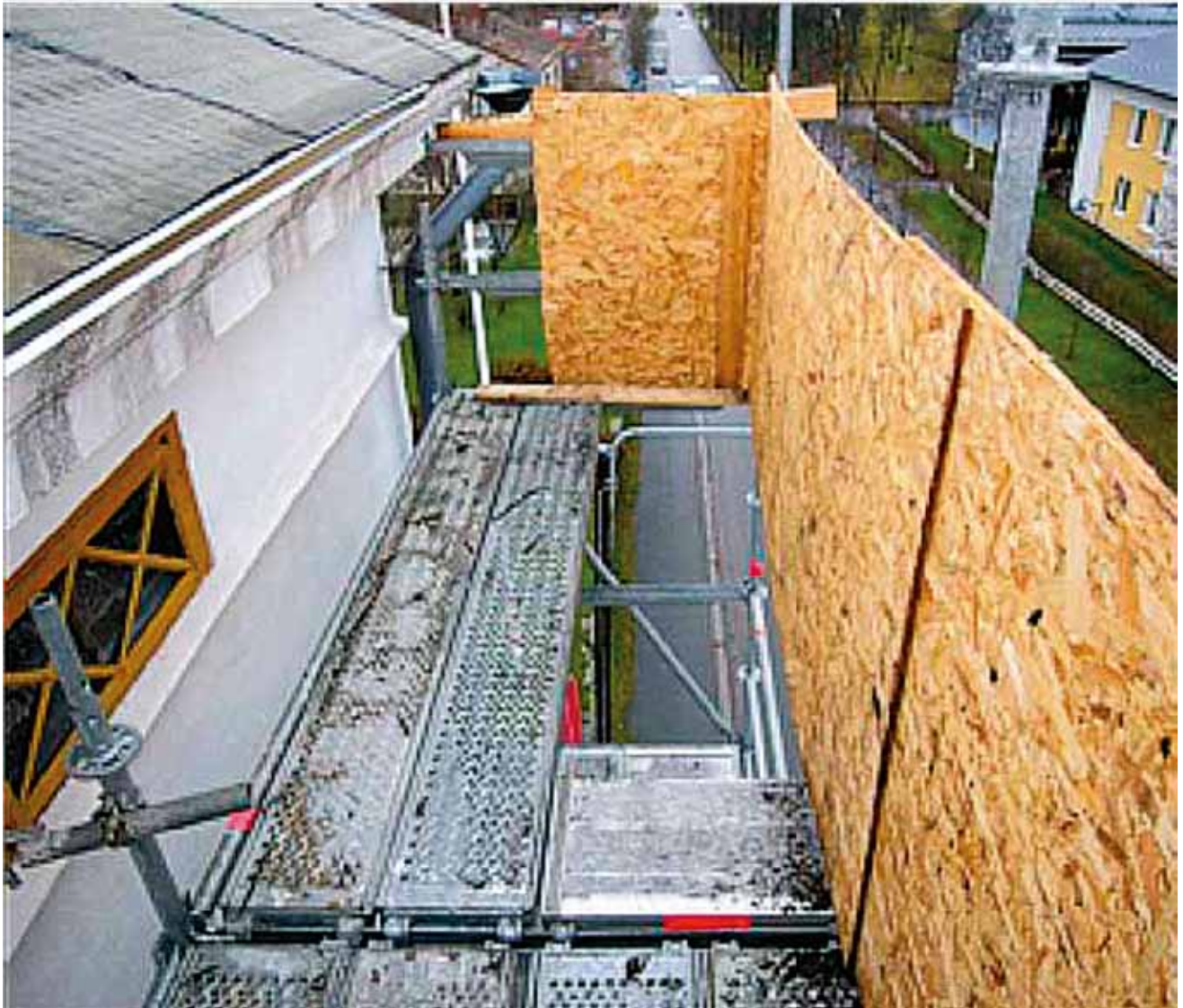
Kuva 4. Vasemmalla räystäs, johon telineeltä asennettiin räystäspelttiä. Keskellä suojaamaton aukko, johon yrittäjä putosi.
