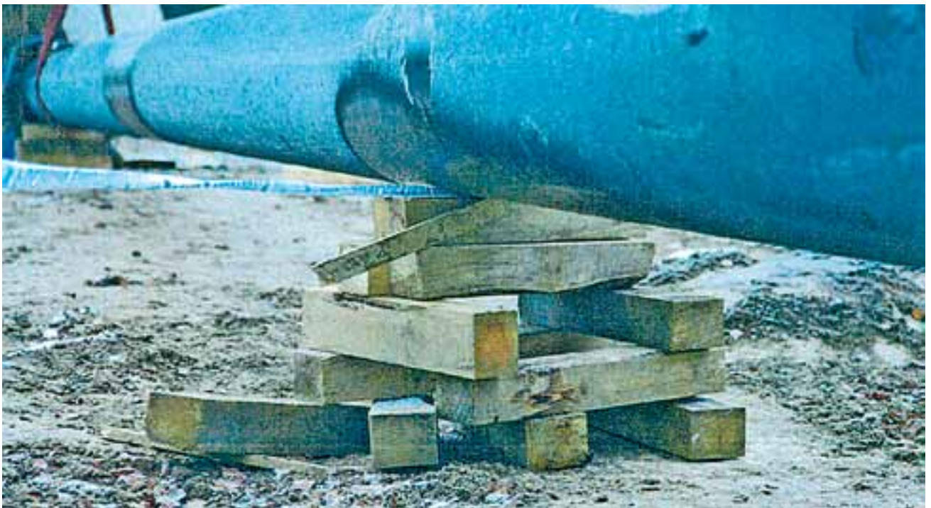
Kuva 3. Vääränlainen tuenta putkilinjan päästä.
