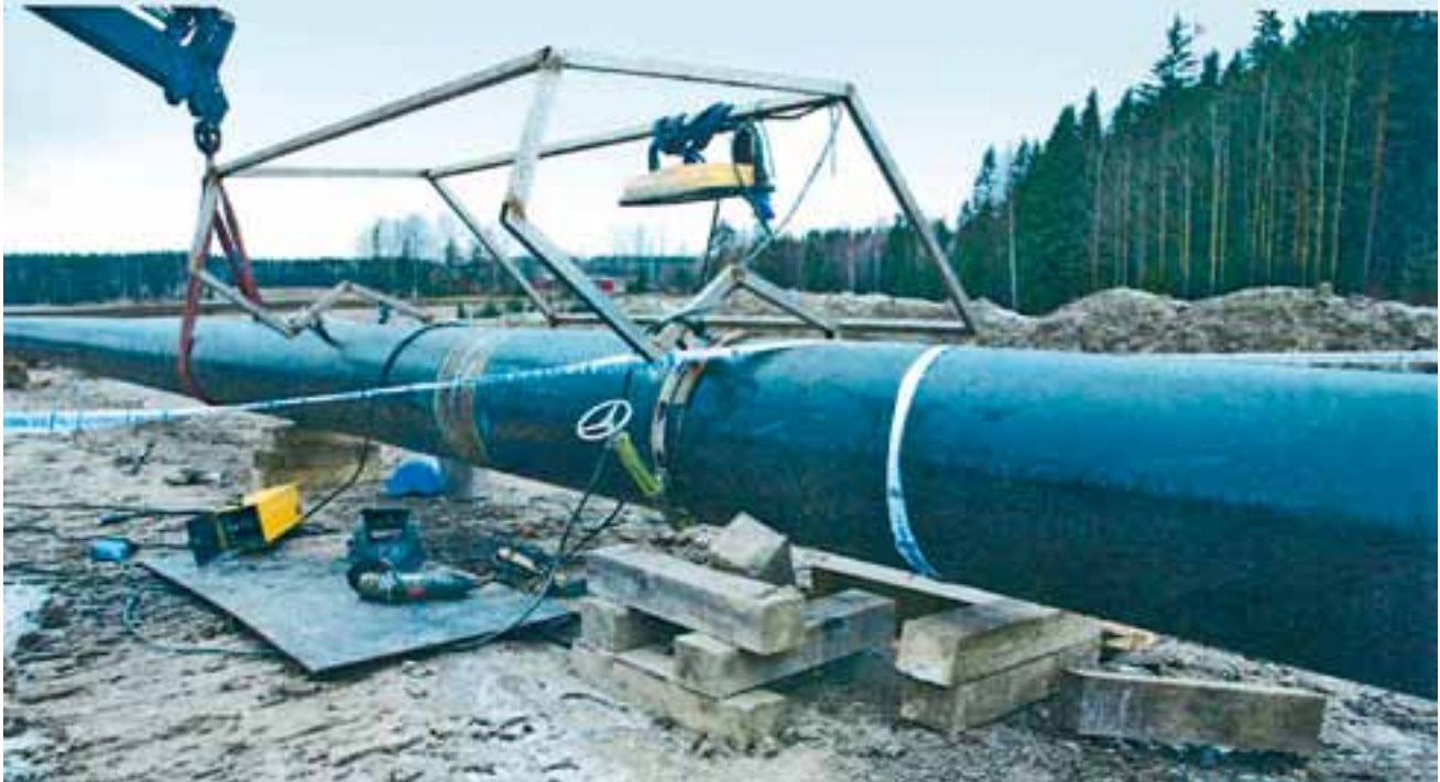
Kuva 2. Poliisin ottama kuva työkohteesta tapaturman jälkeen. Putki on nostettu tapaturman jälkeen uudelleen nosturilla ja katoksen peite on poistettu.
