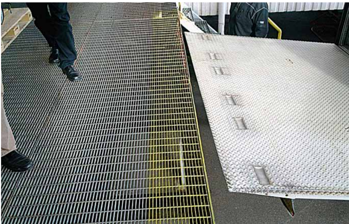
Kuva 3. Lastauslaiturin reuna on hyvä maalata muusta laiturista erottuvalla värillä. Kuvassa näkyy selvästi myös ongelma, jos laiturin edessä oleva maaperä ei ole vaakasuorassa tai kuorma-autoa ei ajeta kohtisuoraan laituria kohden.
