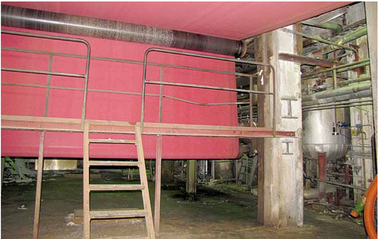
Kuva 2. Työtaso, jolla NN työskenteli. Kuvassa myös kuivaushuopa ja ohjaustelan oikea pää, jota NN oli oletettavasti mennyt puhdistamaan tapaturmahetkellä karhunkielellä.
