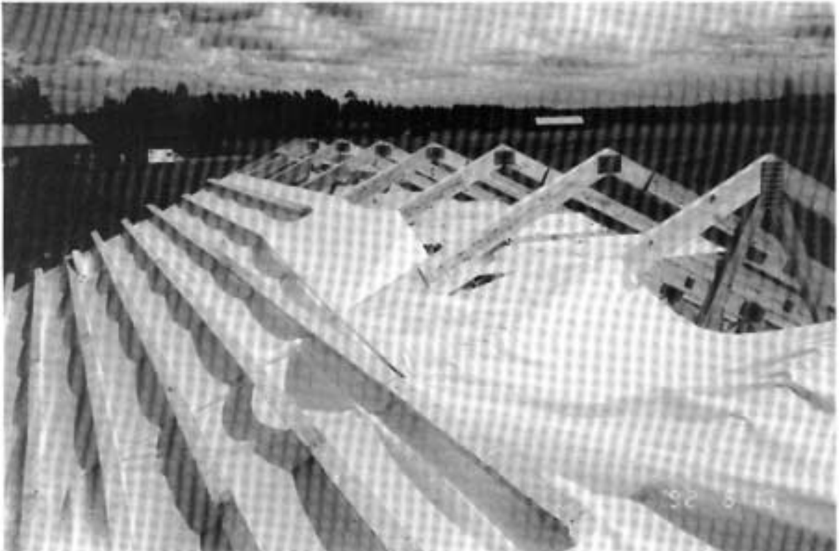
Kuva 2. Vesikatto, jossa osa ruoteita paikallaan. Kuvassa keskellä kohta, josta NN putosi. Hänen viimeeksi naulaamansa ruode jäi kesken kiinnityksen.
