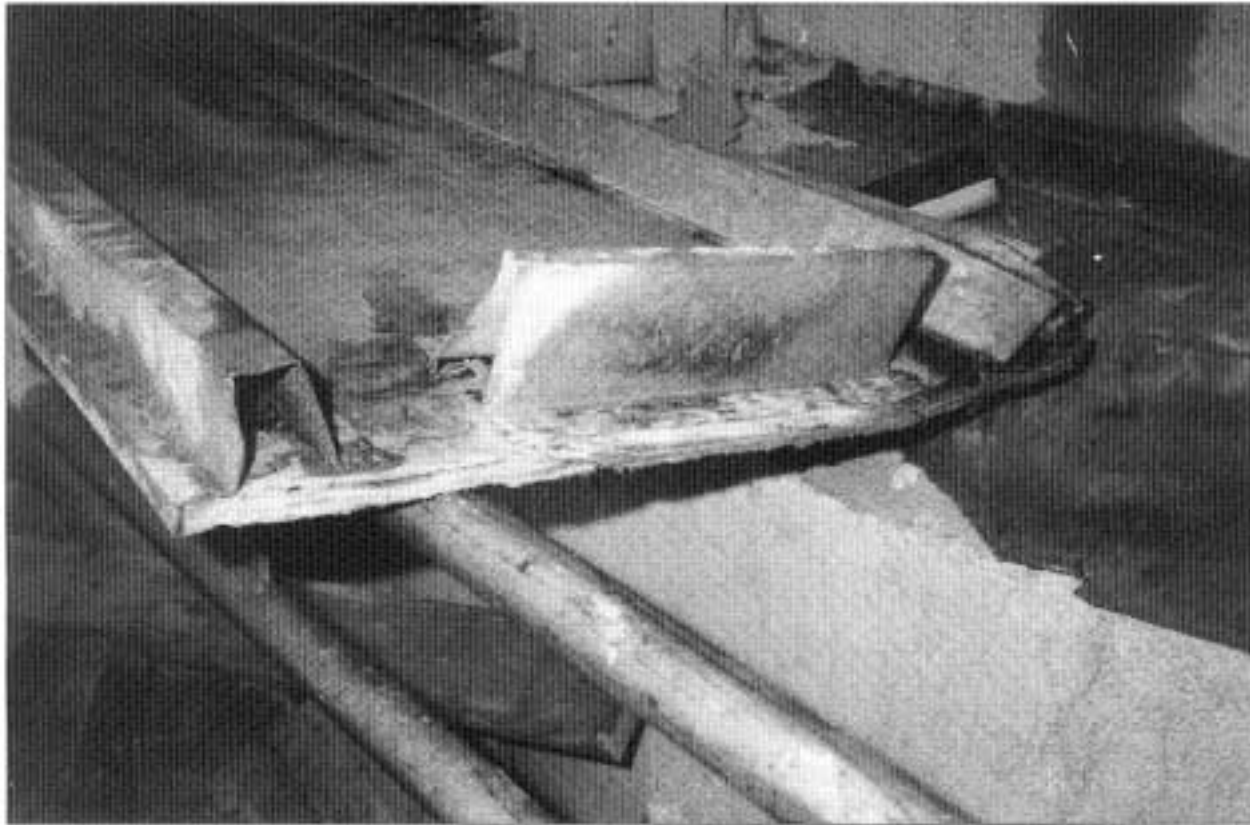
Kuva 3. Pudonneen työtason huonokuntoinen pää.
