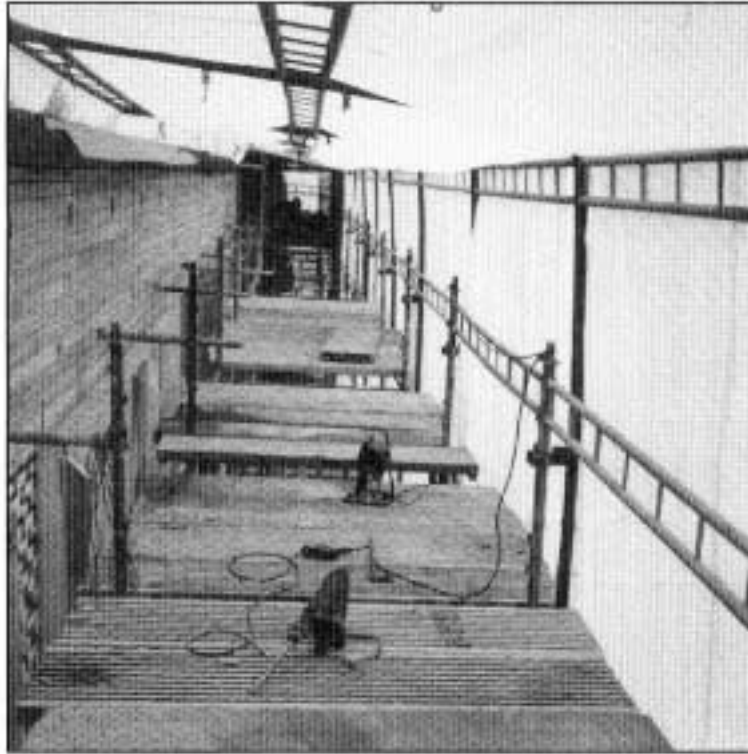
Kuva 1. Taso, jolta NN putosi. Putoamiskohta on ensimmäinen aukko edestäpäin.
