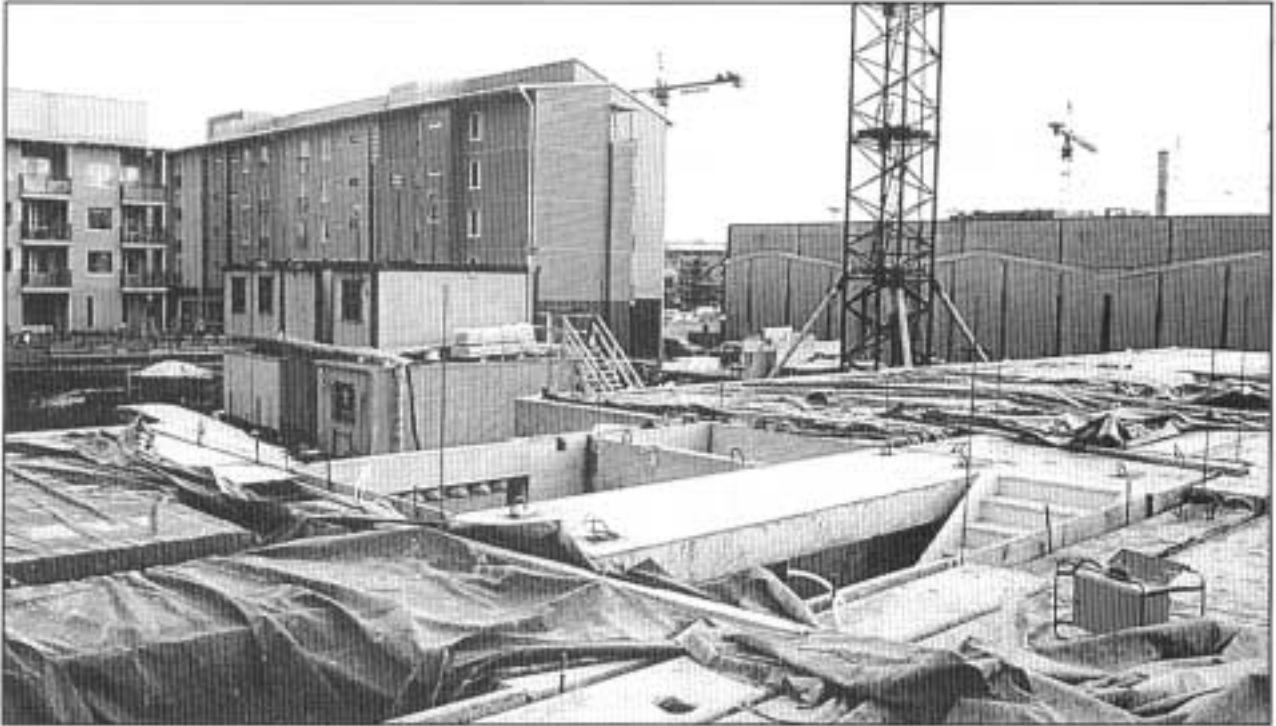
Kuva 1. Tapaturmapaikka oikeassa reunassa näkyvien portaiden alla.
