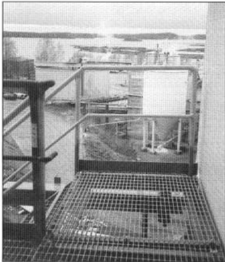
Kuva 1. Taso, jolla NN työskenteli pudotessaan.
