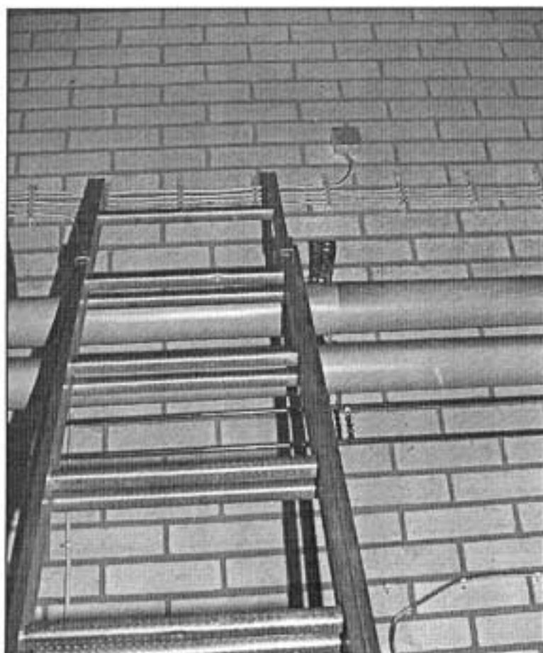
Kuva 2. Jakorasialla, putkia ripustuksineen.
