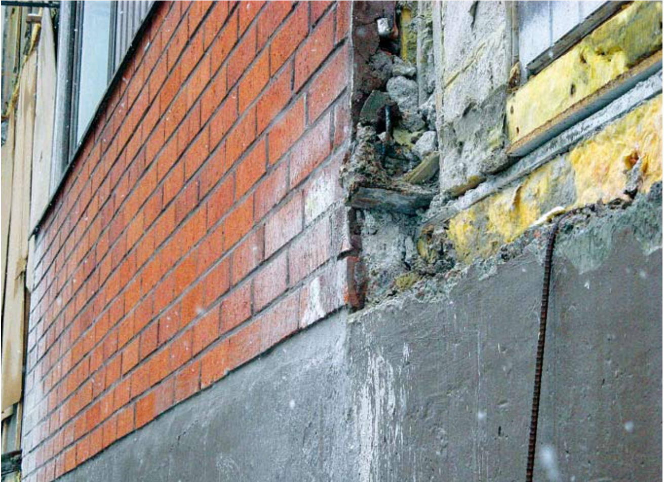
Kuva 2. Alimman parvekkeen toisen sivuseinän puoleinen kenttäratakisko ei ulottunut kuin n. 100 mm ulos seinästä. Suunnitelman mukaan sen olisi pitänyt ulottua 300 mm.
