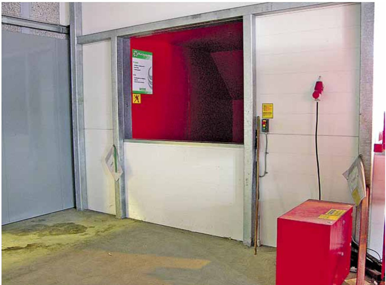
Kuva 2. Jätepuristinkontin käyttöpaikka jätehuoneessa.
