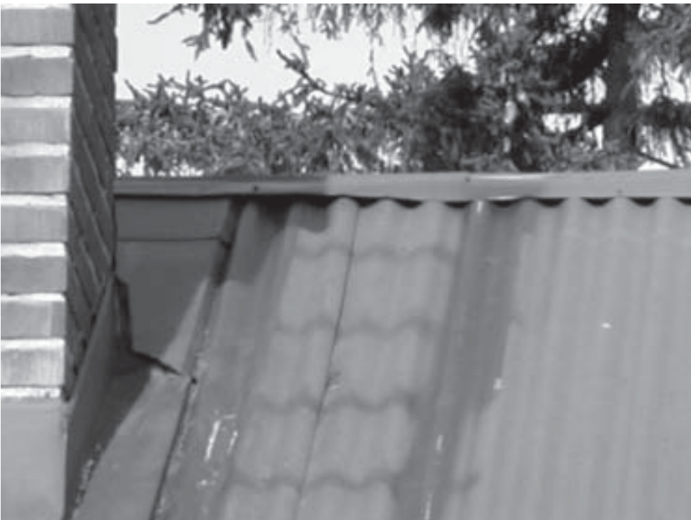
Kuva 2. Lähikuva kohdasta, jossa lapetikkaiden yläpää oli taivutettu katon harjan toiselle puolelle.
