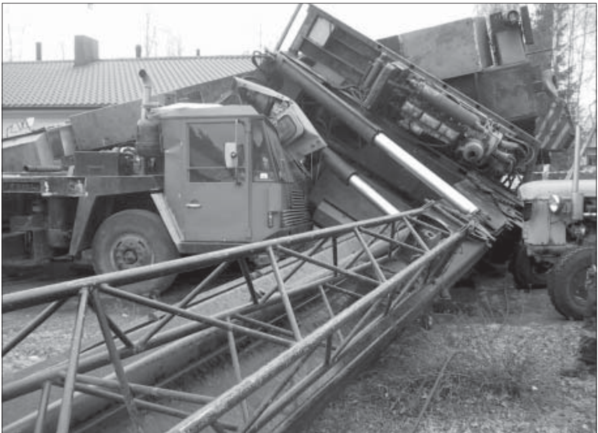
Kuva 2. Kaatuneen nosturin ohjaamo kaatui vieressä seisseen auton ohjaamoa vasten.
