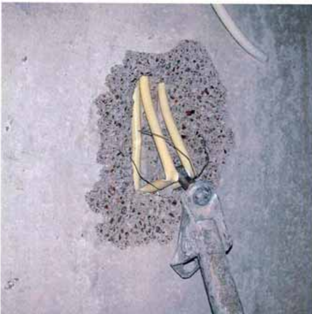
Kuva 5. Väliseinäelementtiin tehtaalla asennettu sisäkierrehylsy eli vemo oli pettänyt. Sisäkierrehylsy oli seinän sisällä olevien sähköputkien takana, melko pinnassa. Kyseiseen sisäkierrehylsyyn oli työmaalla kiinnitetty väliseinäelementtiä tukeva metallinen vinotuki eli tönäri.
