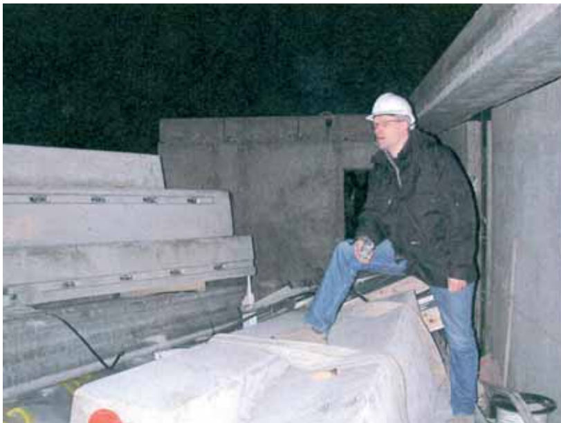
Kuva 2 Tapaturmapaikalla oli todettavissa, että ontelolaaat ja niiden päälle nostetut hormielementit olivat kasa- sa holvin päällä.
