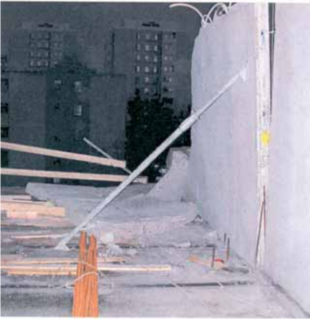
Kuva 3. Väliseinäelementin ulkoseinän puoleinen pää kaatui holville hajoten useaan kappaleeseen.
