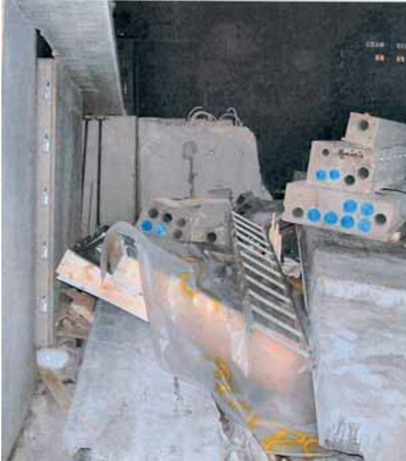
Kuva 1. Paikalla olleiden kertoman mukaan kaksi lähinnä ulkoseinää olevaa ontelolaattaa putosivat ensin alas ja muut kaksi ontelolaattaa välittömästi niiden perässä. Samanaikaisesti, kun ontelolaaat putosivat, rikkoutui niiden päiden alla ollut väliseinäelementti.
