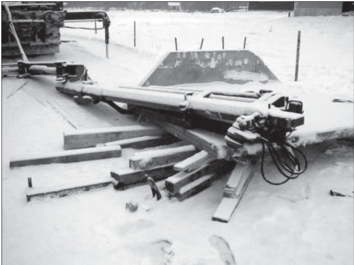
Kuva 2. Elementin päälle kaatunut nosturin pylväs.
