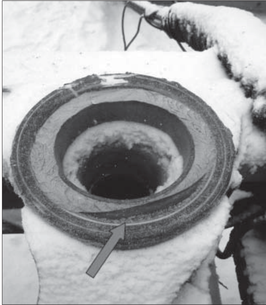
Kuva 3. Pylvään katkeamiskohta. Nuoli osoittaa väsymismurtumaa.
