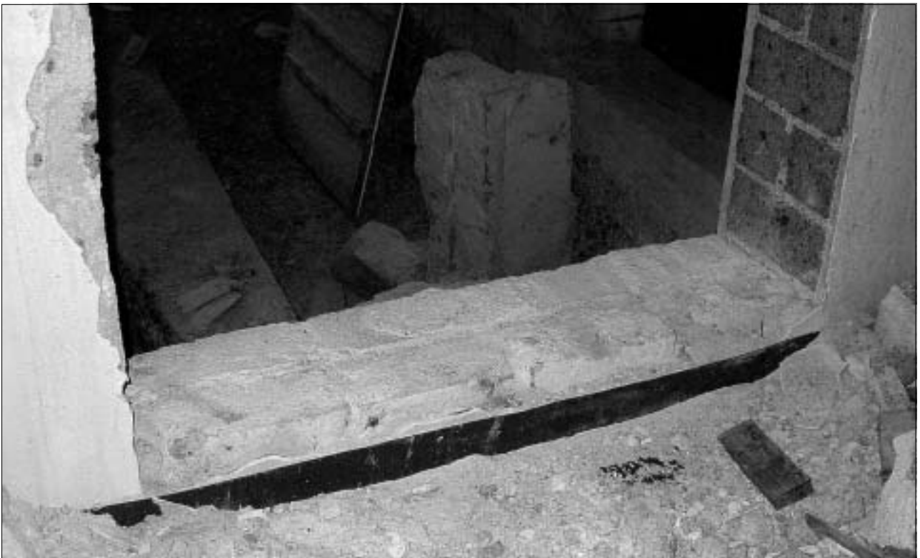
Kuvat 1 ja 2. Purettu oviaukko, piikkausjälkiä.
