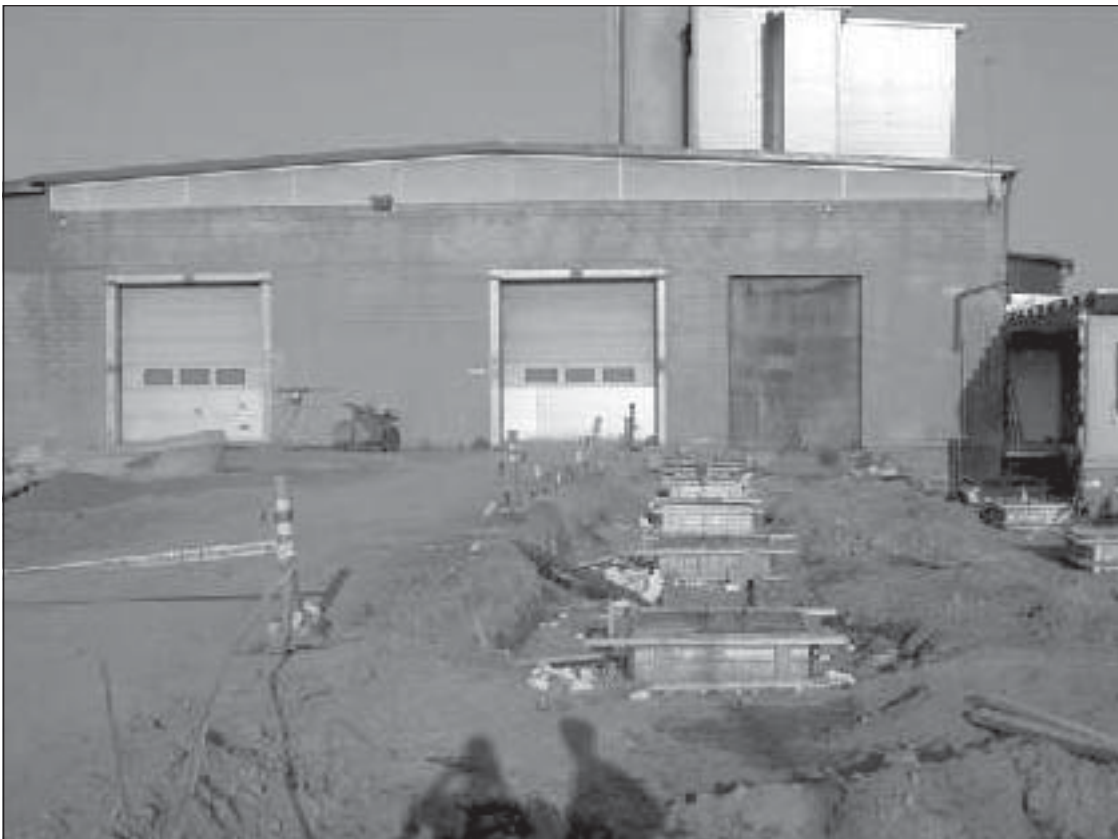
Kuva 2. Ajoreitin muusta työmaasta erottavaa lippusiimaa ei olttu vedetty reitin molemmille puolille.
