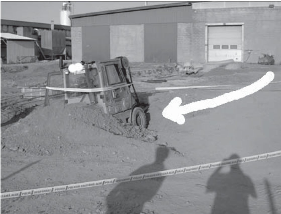
Kuva 1. NN peruutti trukin työmaa-alueen läpi kulkureitin vieressä olleeseen an-turakaivantoon, jolloin trukki kaatui. Kuvassa trukki on jo nostettu pystyyn.
