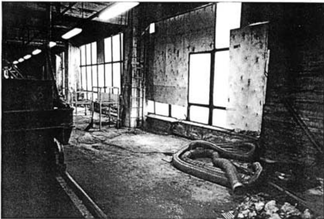
Kuva 3. Viikko työtapaturman jälkeen rikkoi räjähdys ikkunaseinää.
