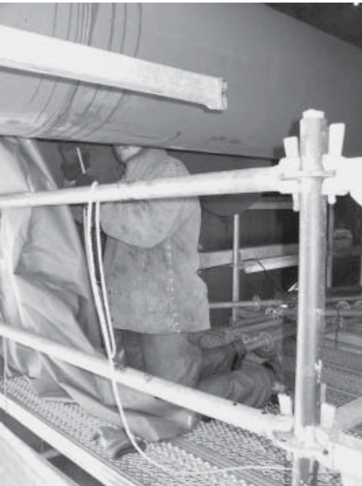
Kuva 2. Työtelineen kaide ja merivesiputki. NN:n pää jäi niiden väliin. NN oli tuolloin polvillaan.
