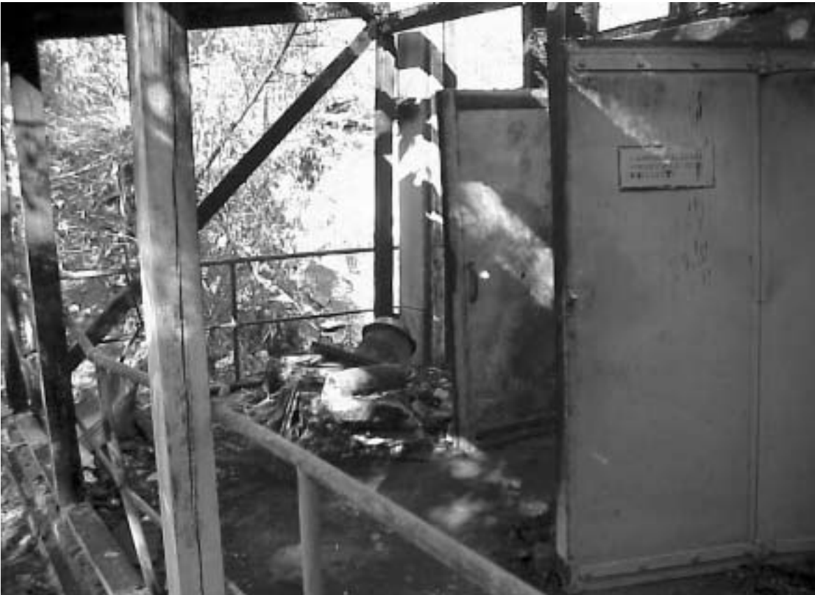
Kuva 4. Puristinhuoneen seinät ja ovet räjähdysten jälkeen.
