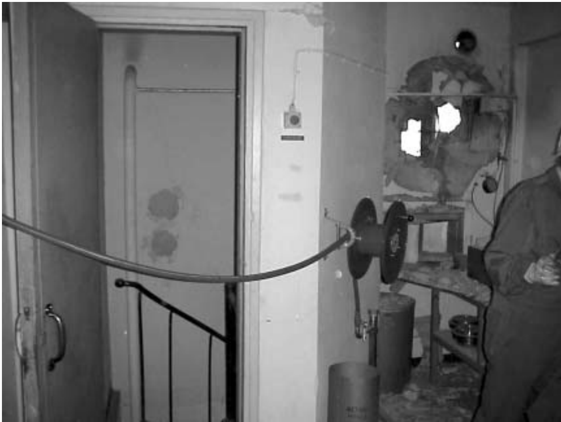
Kuva 5. Suojatilan ja puristushuoneen väliseen seinään tulleet reiät.
