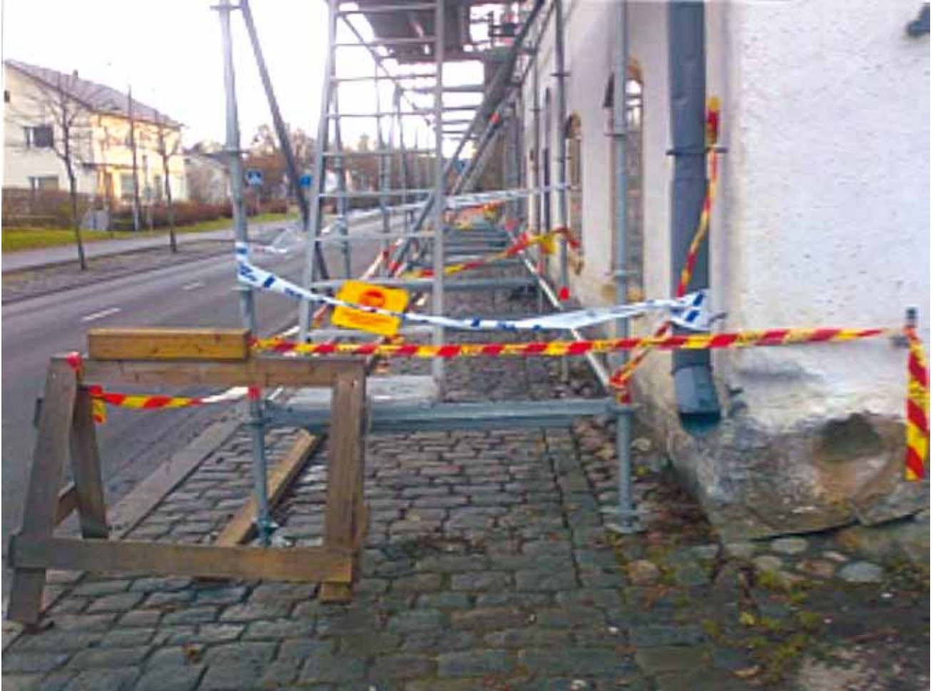
Kuva 1. Kadun puolelle työmaan kohdalle pystytetty kulkueste. NN putosi kulkuesteen ja telineen päädyn väliin.
