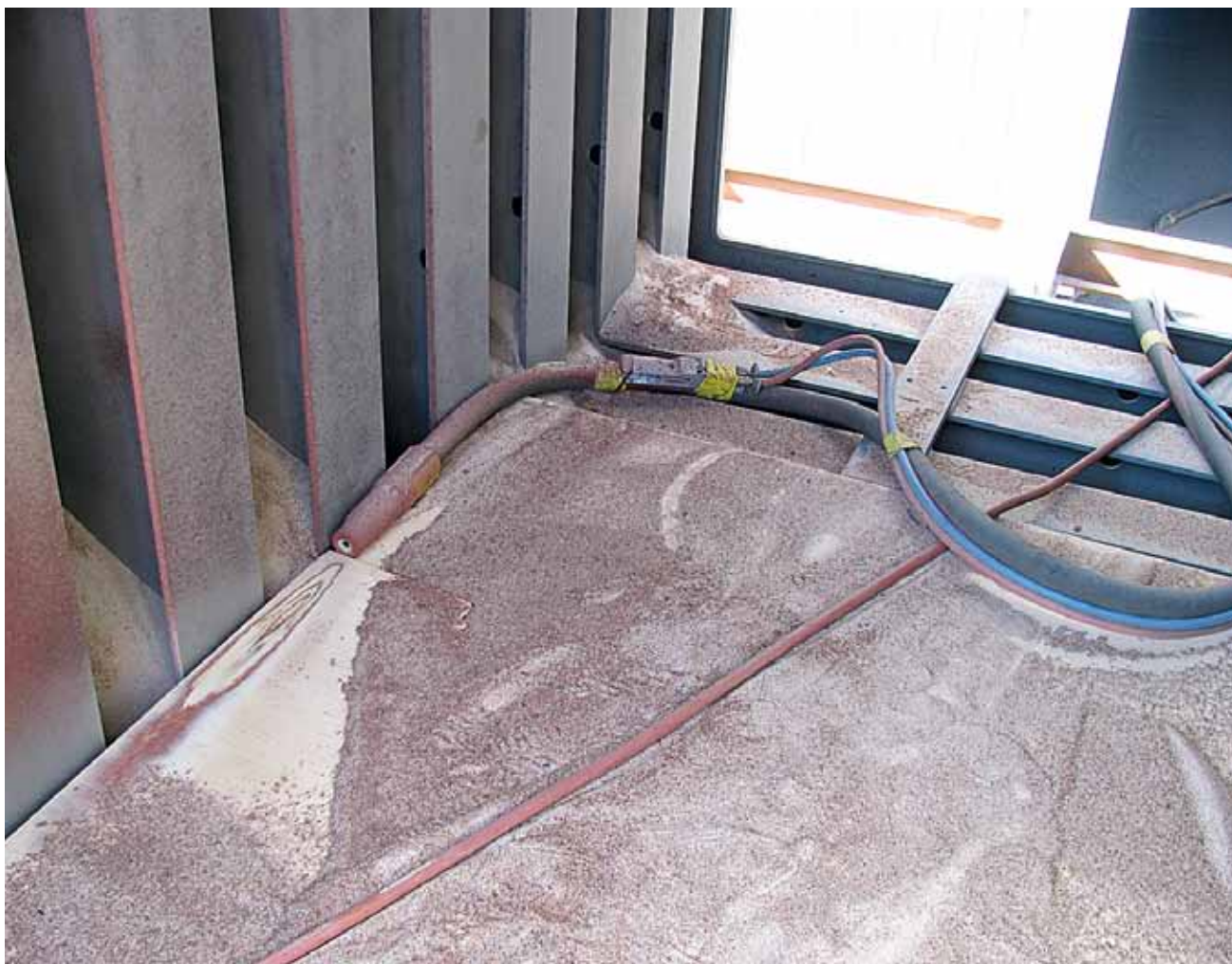
Kuva 1. NN työskenteli tapaturmahetkellä muotin sisällä ja mahdollisesti kompastui metallipalkkien väleissä olleisiin rakoihin.
