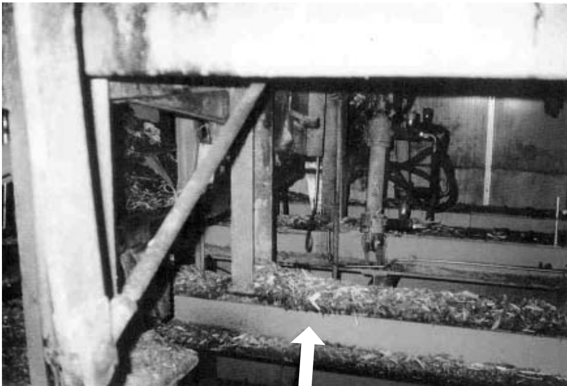
Kuva 4. Kuorien peittämä palkki (nuoli, keskellä alhaalla), minkä päällä NN seisoi tankoa asentaessaan.
