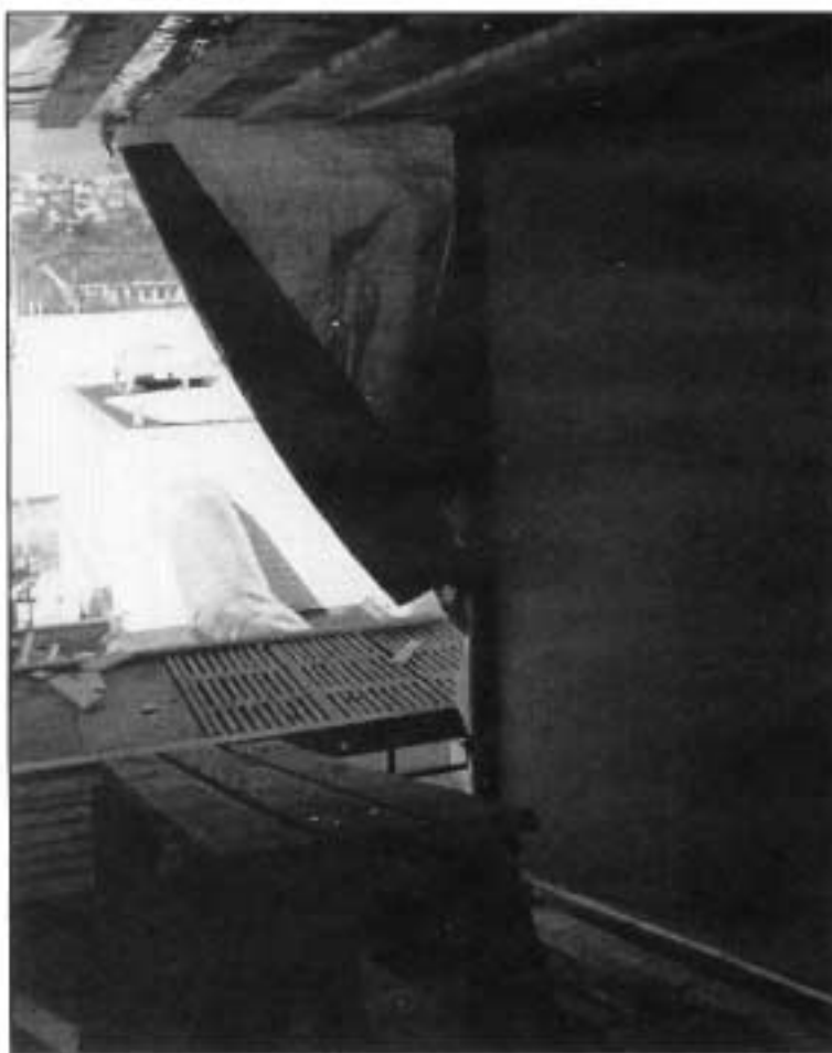
Kuva 2. Kuva ilmastointikonehuoneen sisästä.
