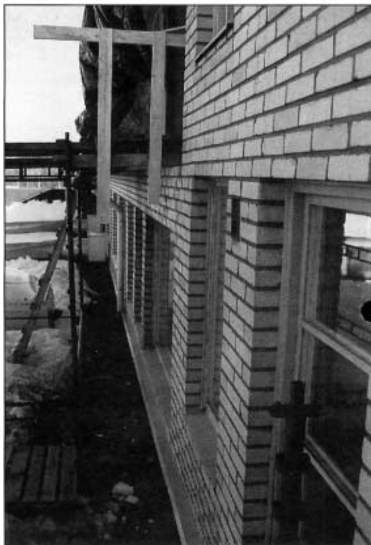
Kuva 3. Rakennustelineiden ja seinän välin jäänyt aukko.
