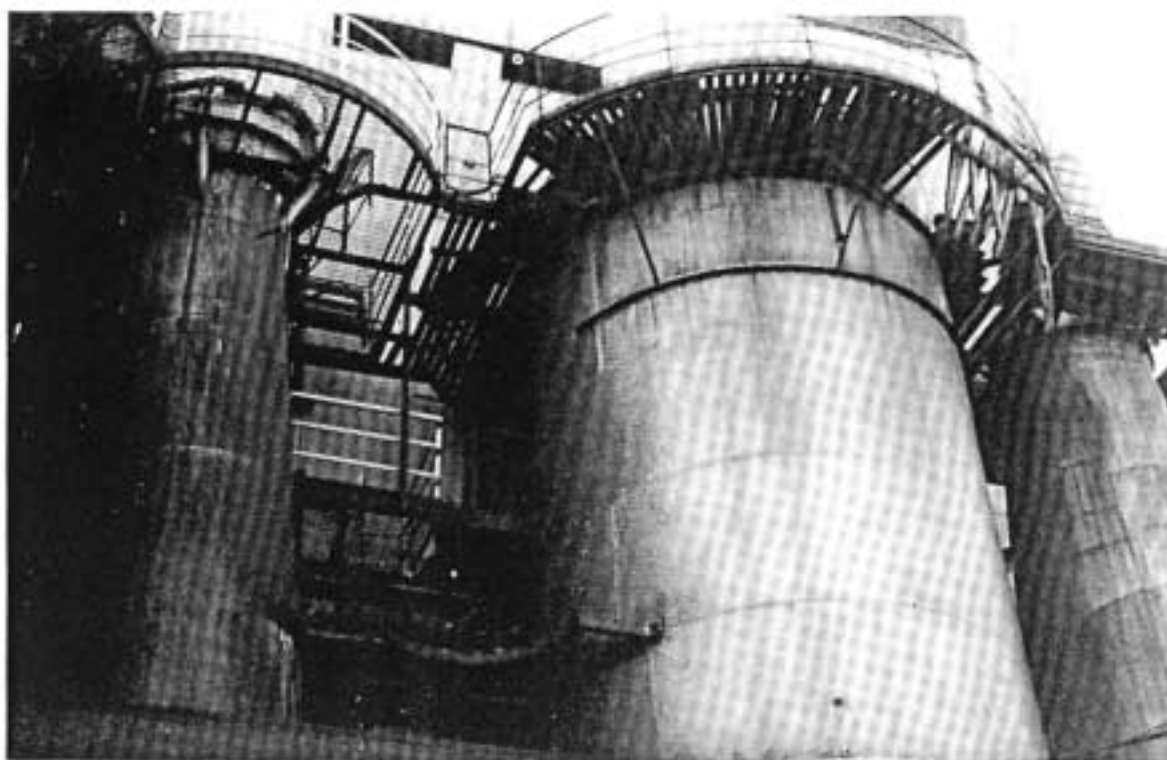
Kuva 1. Oikealla lahonnut, käytöstä poistettu hoitotaso, jonka taakse jäävällä osalla suurin määrä romusta oli. Alareunassa näkyy mainittu katto. Vasemmalla kunnostettu hoitotaso.
