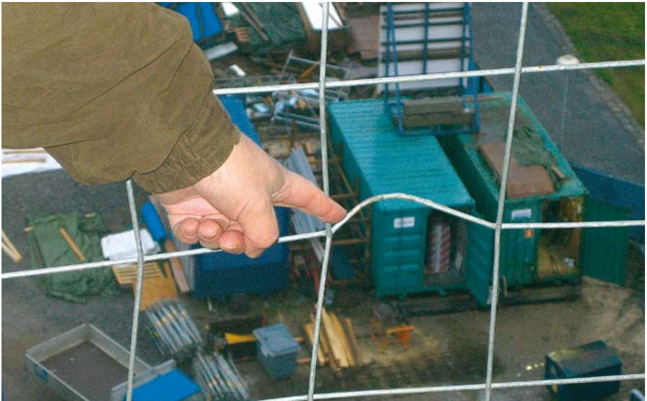
Kuva 1. Sormi osoittaa lyhennyskoukun tarttumiskohtaa yhdeksännen kerroksen parvekkeen kaiteeseen. Kaiteen verkkolanka vääntyi tarttumistilanteessa.
