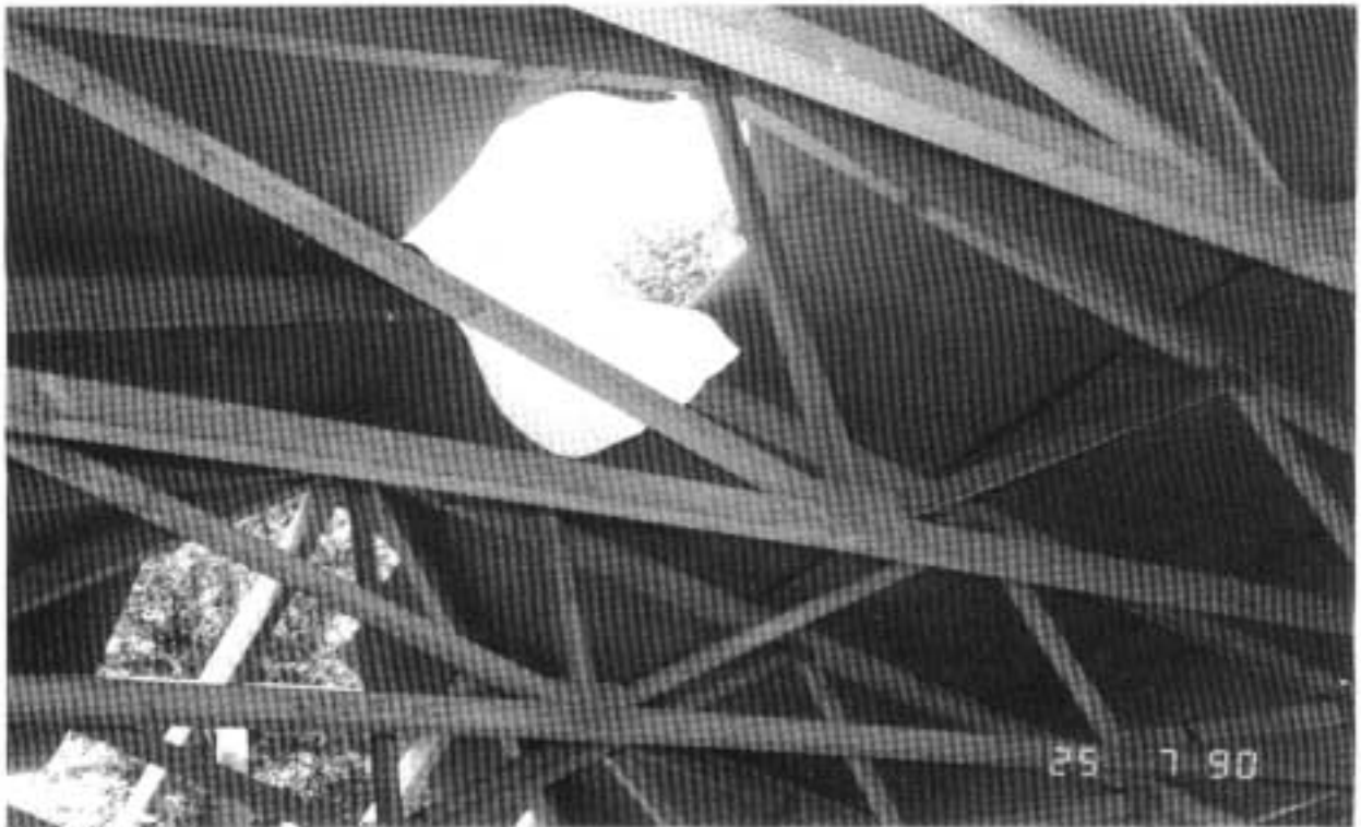
Kuva 1. Kattoon repeytynyt aukko alhaalta päin katsottuna.
