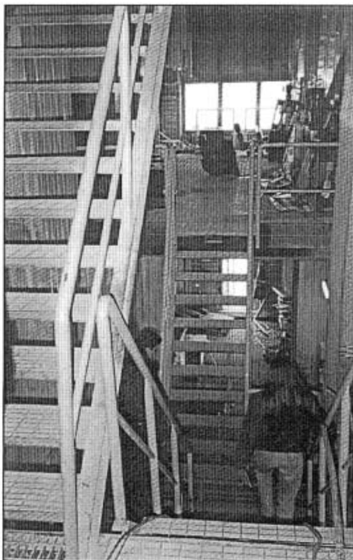
Kuva 1. NV ei jatkanut portaita alas vaan kuvan keskellä olevia portaita ylös. Takana ikkunat.
