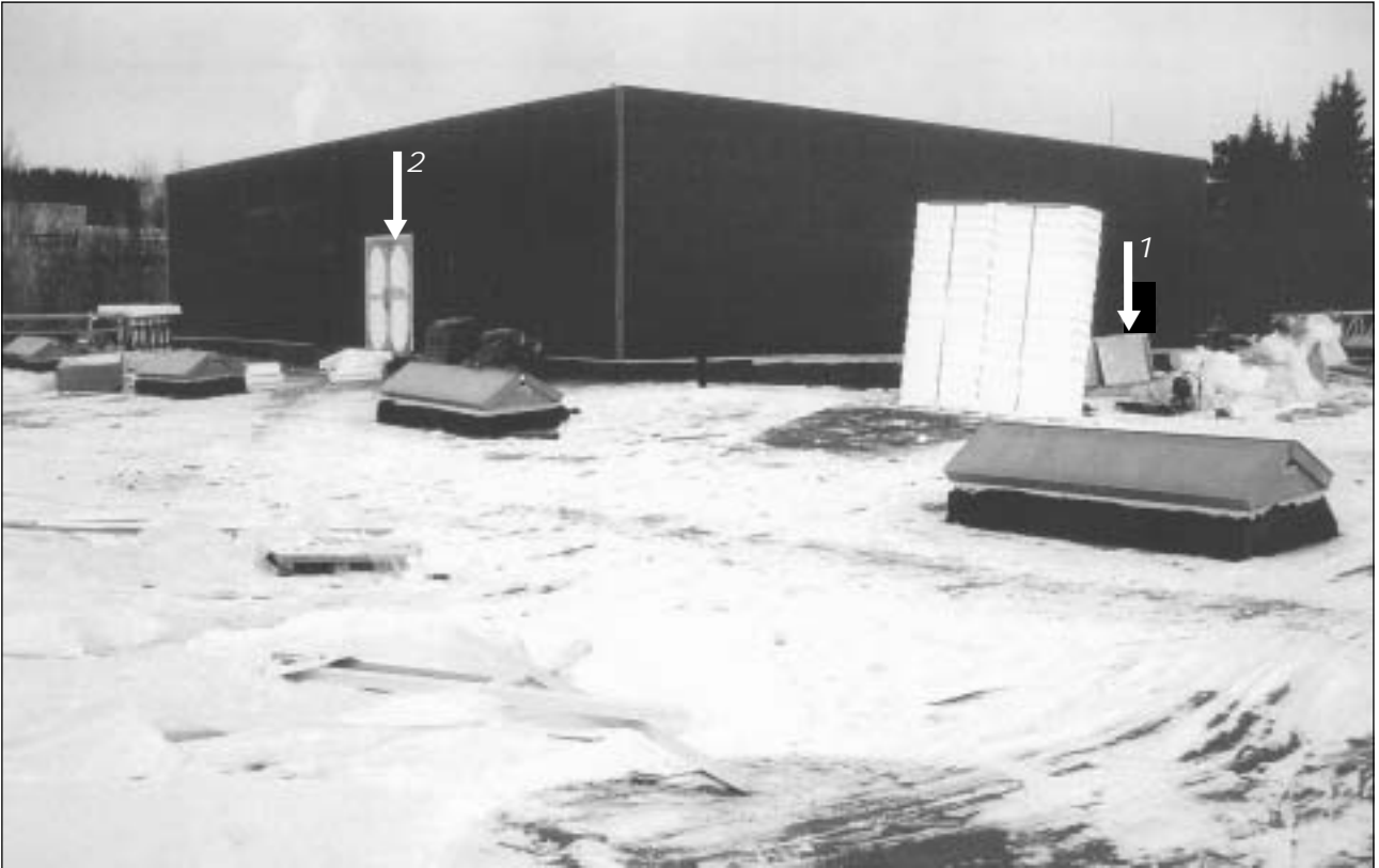
Kuva 1. Kattotasanne, konehuone. Nuoli 1 vanerit, nuoli 2, oviaukko (tapahtumahetkellä siis oveton).
