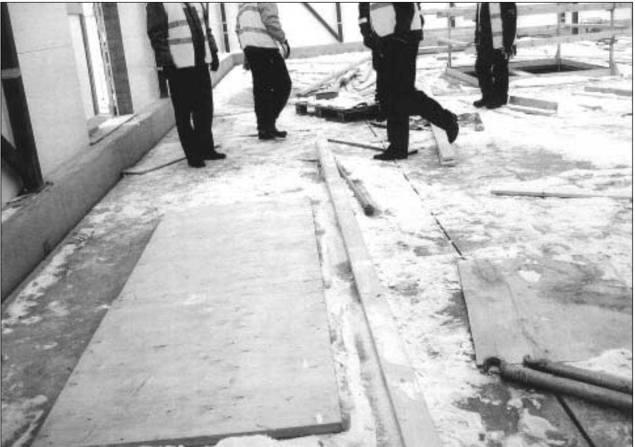
Kuva 2. Tämä suojakansi nostettiin työtaturman sattumisaikaan. (Kts. kuva 3).
