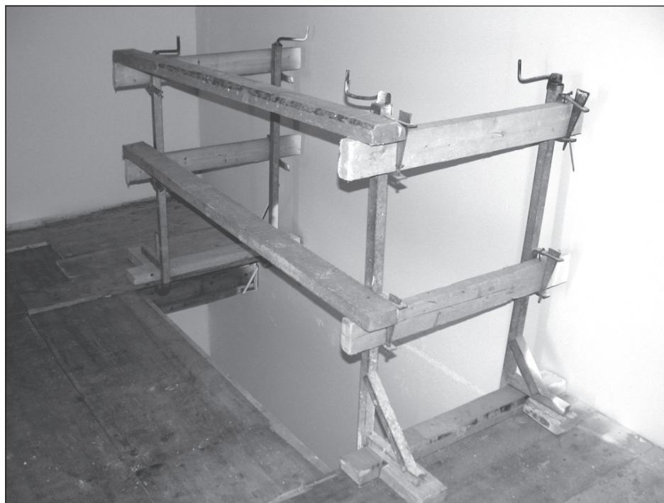
Kuva 1. Maalari putosi hissini johteiden asennusta varten jätetystä suojaamattomasta aukosta (2,0 m x 0,73 m) kuilun pohjalle. Kuvan suojaus on asennettu aukkoon tapahtumien jälkeen.
