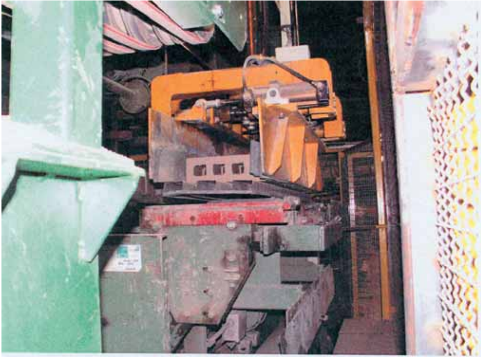
Kuva 3. Tarttuja hakee tiilet normaalissa automaattiajossa.
