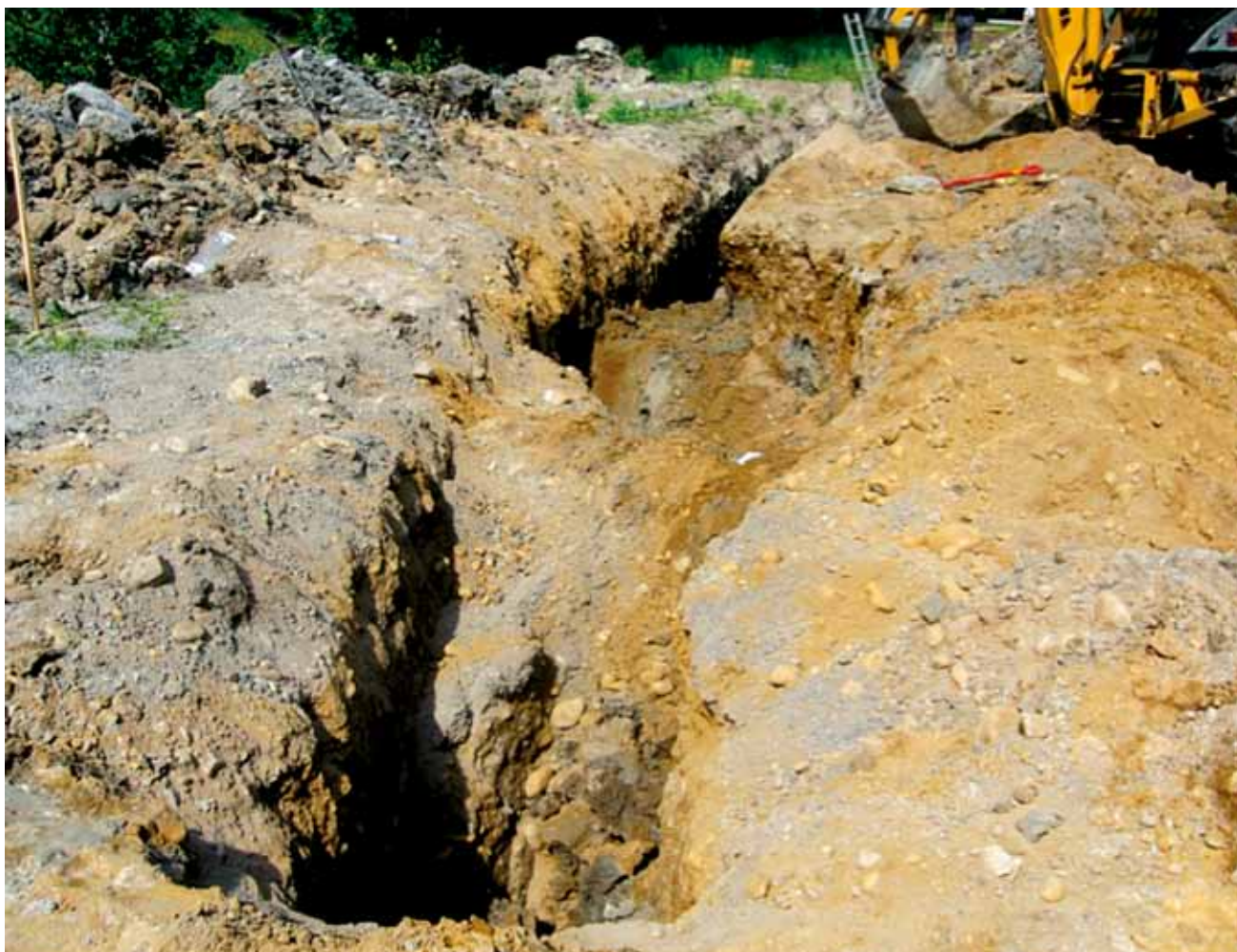
Kuva 1. Kaivanto tapaturman jälkeen. Sortuman pituus noin 6 metriä.
