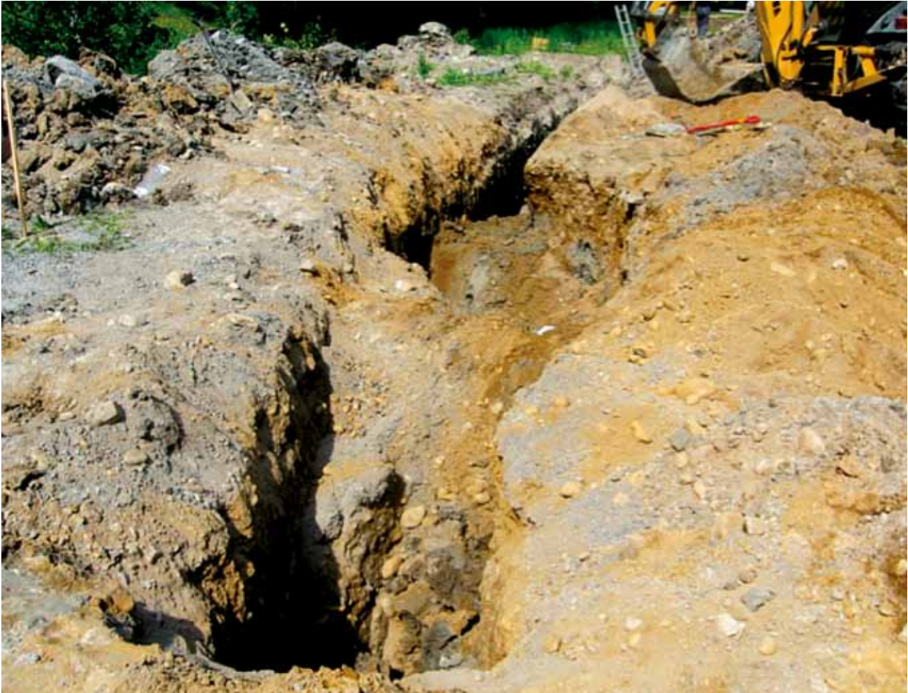
Bild 1. Grävschaktet efter olycksfallet. Rasets längd ca 6 meter.
