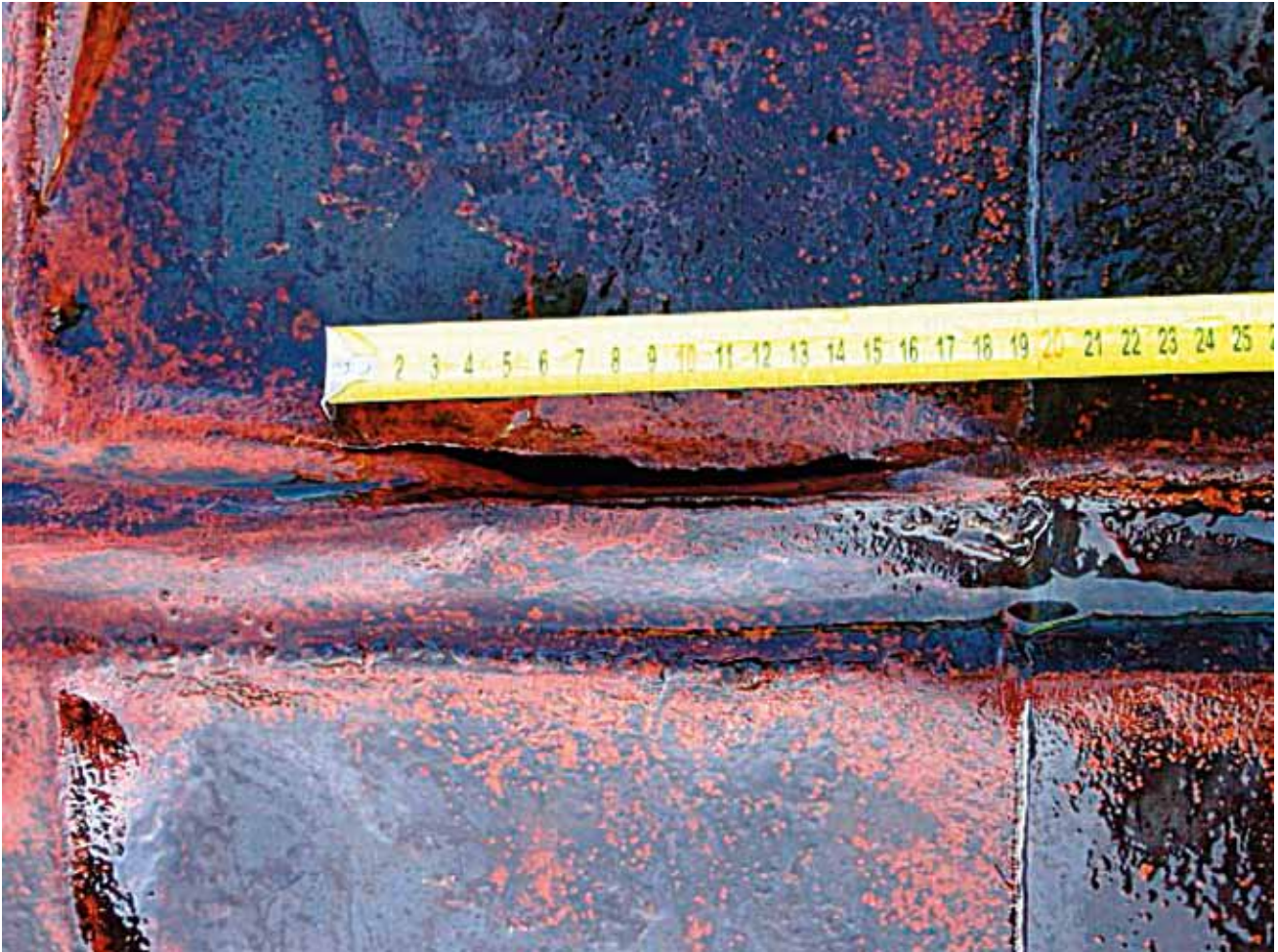
Kuva 1. Kuljetusaluksesta löytnyt yksi 16 cm pitkä halkeama, josta vettä pääsi vuotamaan tankkiin.
