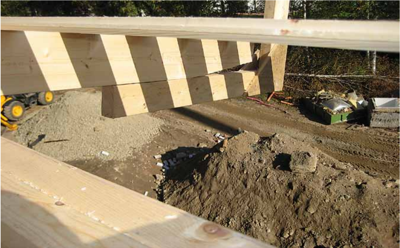
Kuva 3. Lähikuva kaiderakenteesta. Kuvan on ottanut Rakennusliiton aluetoimitsija normaalin työmaakäynnin yhteydessä ennen tapaturmaa. Aluetoimitsija esitti työmaan mestarille tuolloin epäilyksensä kaitteen kestävydestä. Kuvassa näkyy kuinka kattotuolin alakulma on viistottu.
