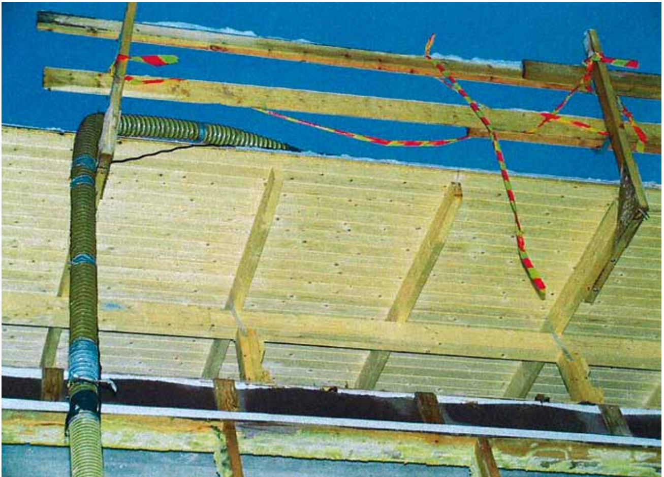
Kuva 2. Kuva suojakaiteen rakenteesta räystään alapuolelta. Kuva on otettu putoamiskohtan vierestä, putoamiskohta on kuvan vasemmalla puolella.
