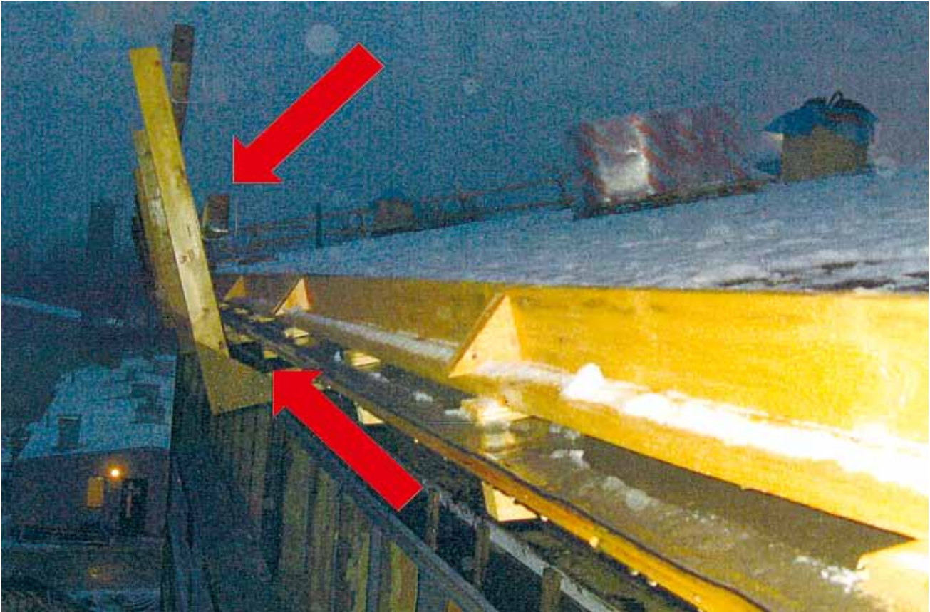
Kuva 1. Kuva suojakaiteen rakenteesta räystäään tasalta. Kaiteen johteita ei ole kiinnitetty. Nuolet osoittavat vastaavia kohtia, joihin NN on mahdollisesti tukenut jalan ennen putoamista. Kuvasta on poistettu tunnisteet. Kuva on otettu läheltä putoamiskohtaa.
