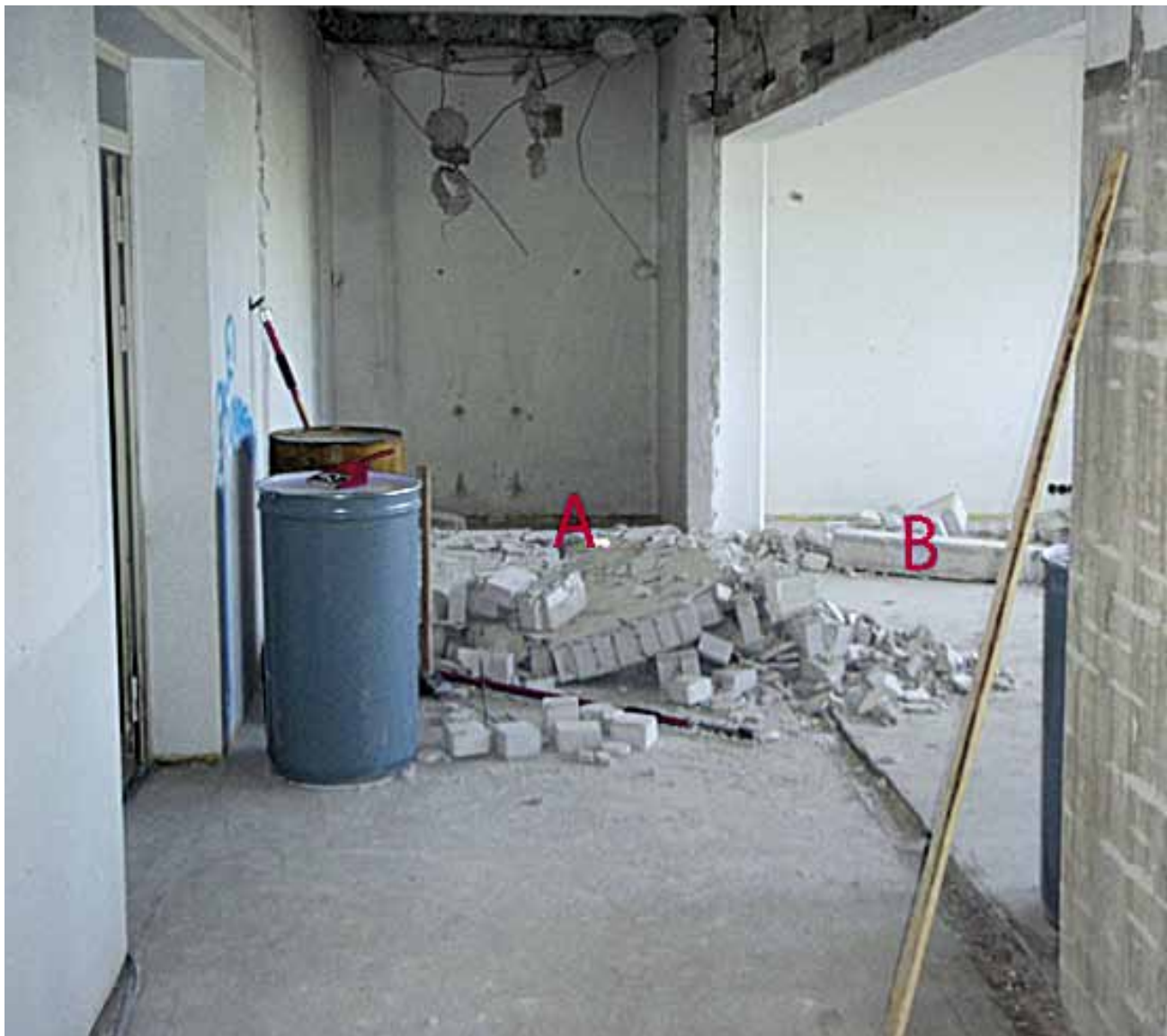
Kuva 1. Kaatunut seinä tapaturman jälkeen. NN:n sijainti tapaturman jälkeen merkitty kuvassa "A". Tapaturman jälkeen NN löydettiin sortuneen seinän päältä, NN:n jalat olivat kuvassa vasemmalle päin. NN:n päälle pudonnut kappale merkitty kuvassa "B". Tapaturman jälkeen, mutta ennen valokuvan ottamista seinän pudonneita kappaleita on siirretty.
