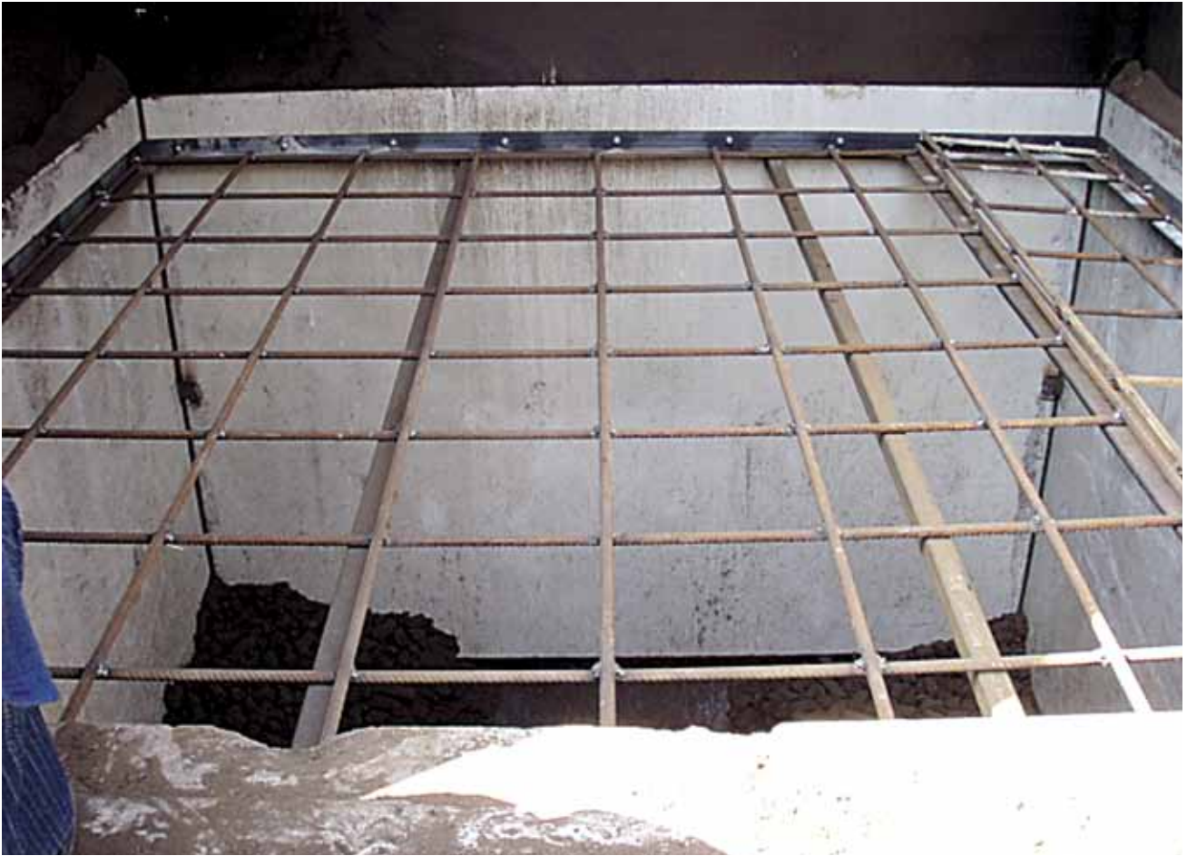
Kuva 1. Siilon ylätasanne tapaturman jälkeen tehdyn korjaustyön jäljiltä.
