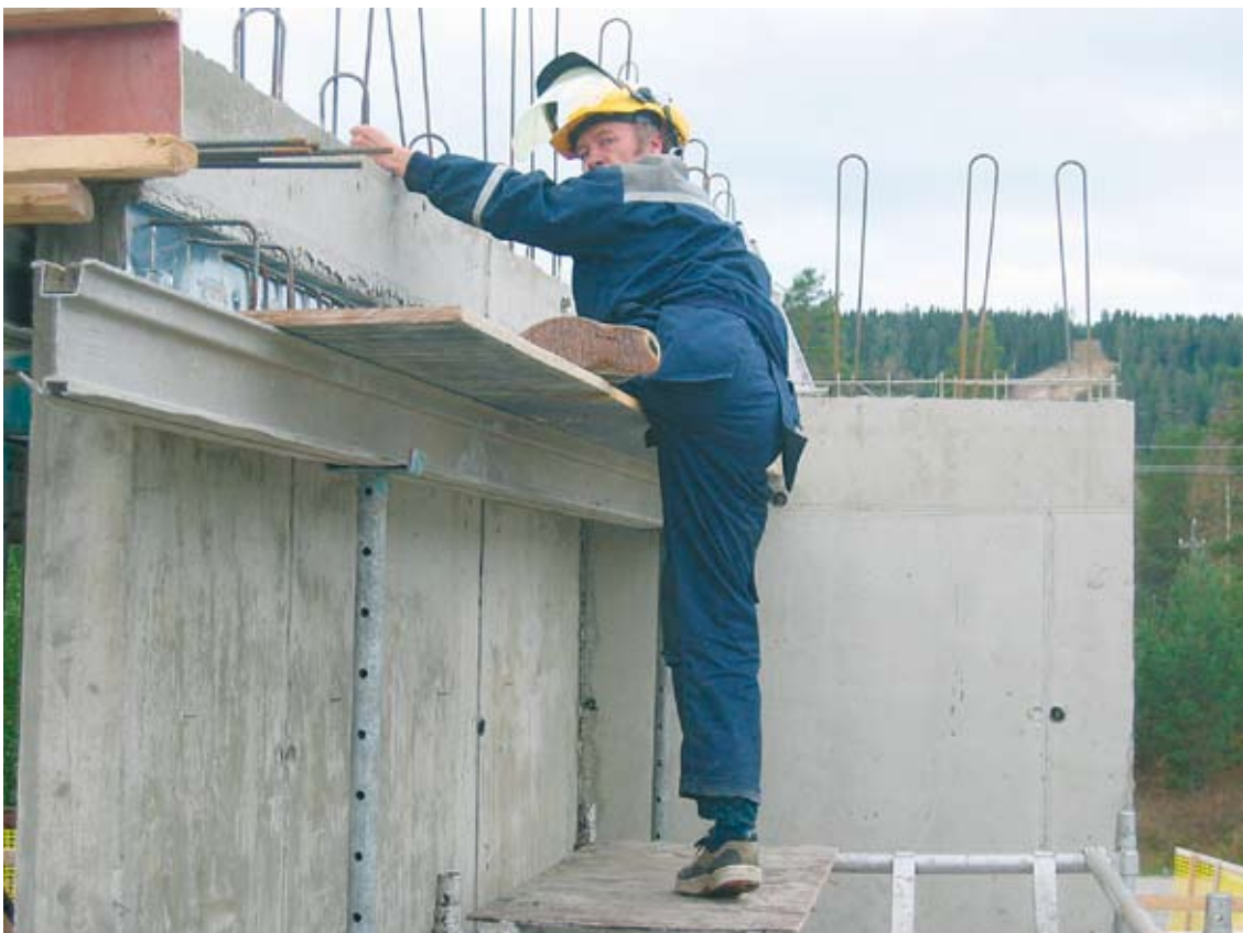
Kuva 2. Lavastettu kuva NN:n oletusta työasennosta tapaturmahetkellä.
