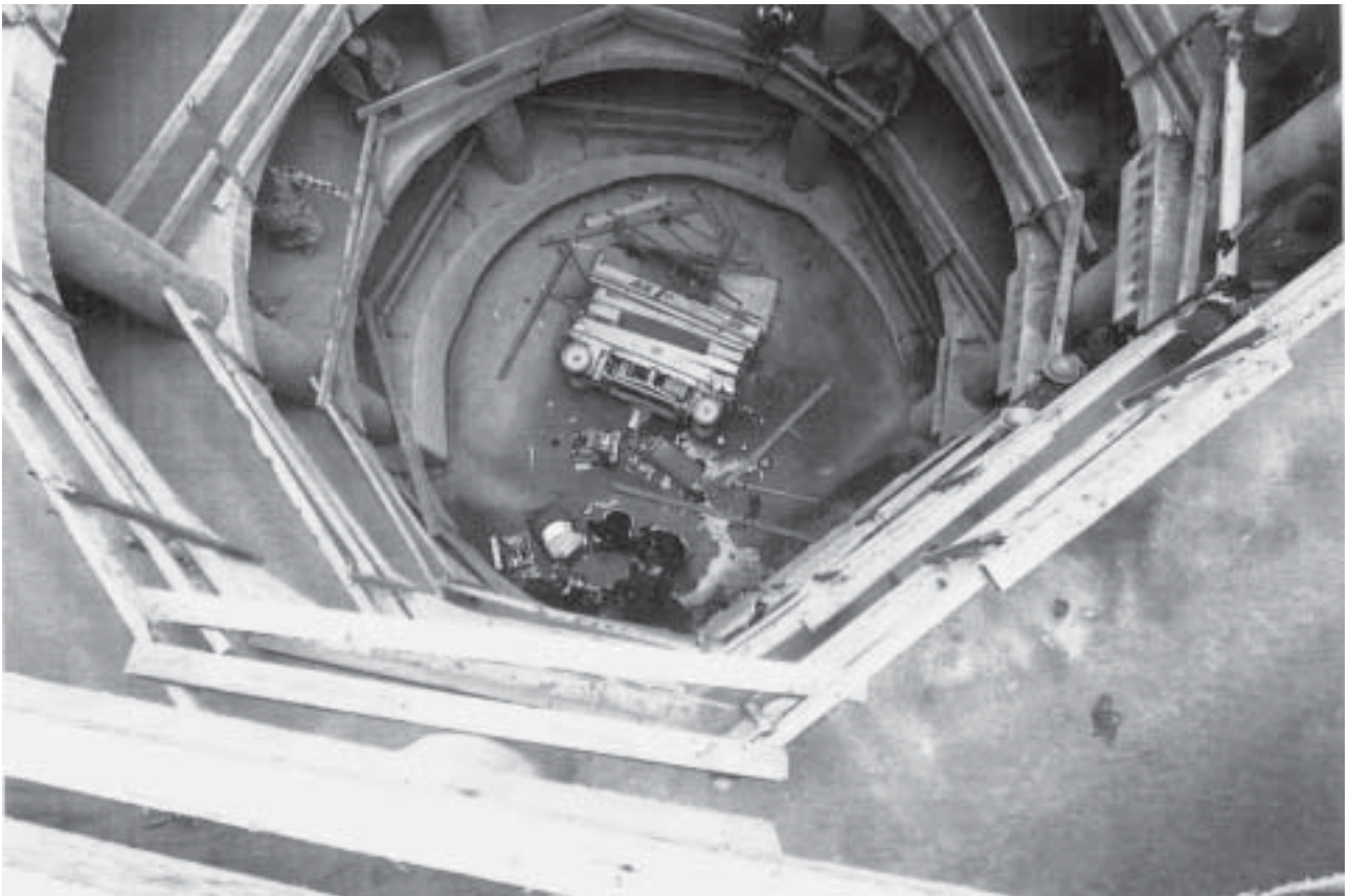
Kuva 4. Nostin putosi pohjakerrokseen.
