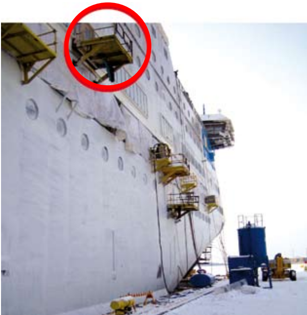
Kuva 1. Laivan ulkoreunalla olevia uloketasoja. Tapaturmaan johtanut haalaustyö tapahtui ympäröidyillä tasolla.
