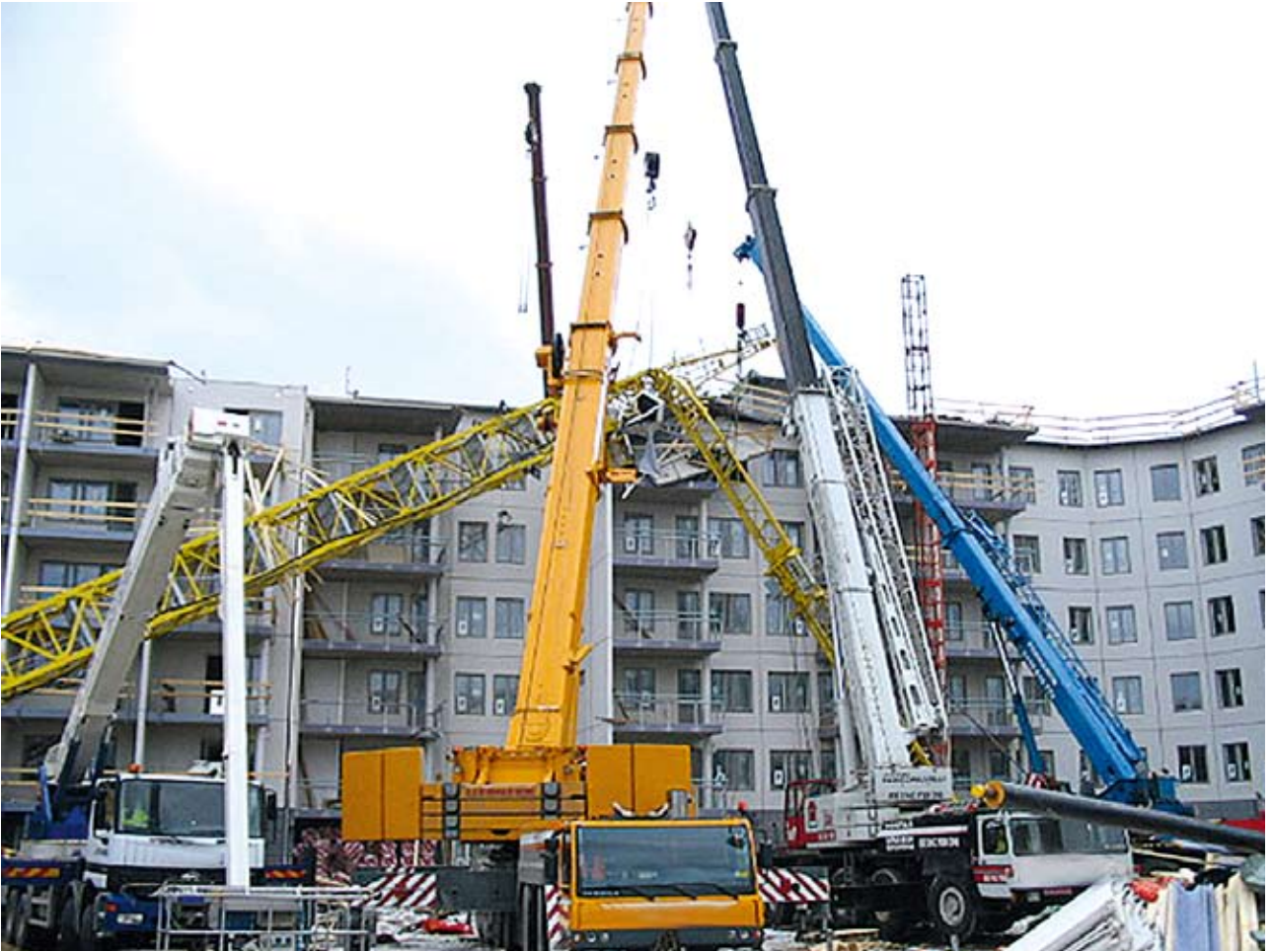
Kuva 4. Yleiskuva tapaturman jälkeen.
