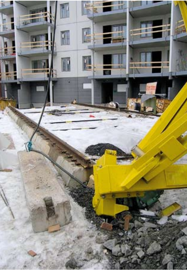
Kuva 1. Torninosturin kiskot. Etualalla näkyy lumetonta kohtaa, jossa poistettu kiskon osa oli ollut aiemmin.
